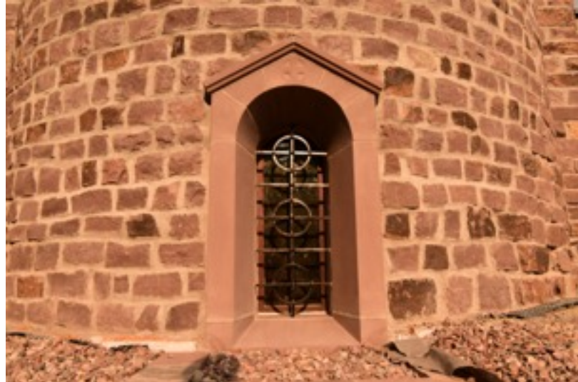
Das Altarfenster der Krypta aus Werkstücken. Im Gitter drei Sonnenkreuze als Hinweis auf die Heilige Dreifaltigkeit !
